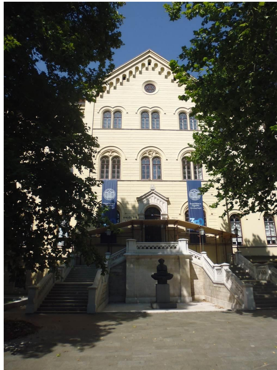
Zgrada Rektorata Sveučilišta u Zagrebu i Pravnog fakulteta teško oštećena u potresu
