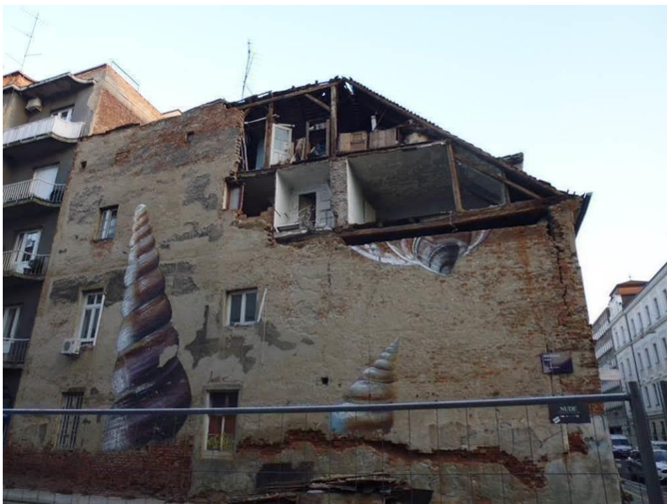
Potres u Zagrebu, 22. 3. 2020. - oštećena zgrada u Petrinjskoj ulici
