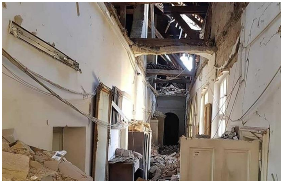
Potres u Zagrebu, 22. 3. 2020. (oštećena zgrada Muzeja za umjetnost i obrt možda otvara pitanje obnove tako da se pomoćni objekti u dvorištu zamijene novm dvorišnom interpolacijom koja će svojom vrijednošću opravdati i obnovu uličnog dijela teško oštećene zgrade, a u kojoj će ujedno biti i potpuno nova Škola primijenjene umjetnosti i dizajna, printscreen Facebook MUO)
