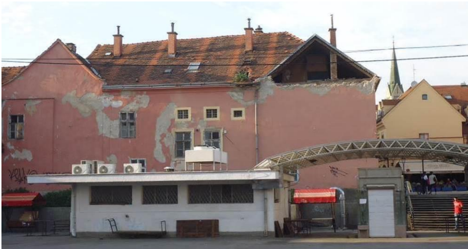
Potres u Zagrebu, 22. 3. 2020. - oštećena zgrada na Dolcu
